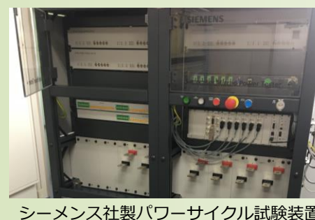
シーメンス社製パワーサイクル試験装置
